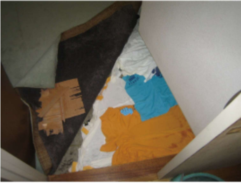
床カーペット漏水
