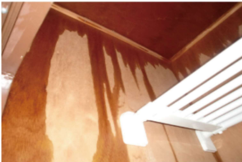
下階押し入れ天井漏水
