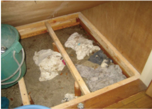
押入れ床漏水
